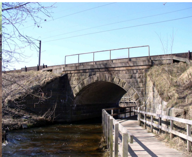
Vandløbsbro med risiko ?
