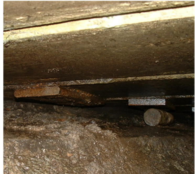
Korroderet rulleleje i yderstilling
