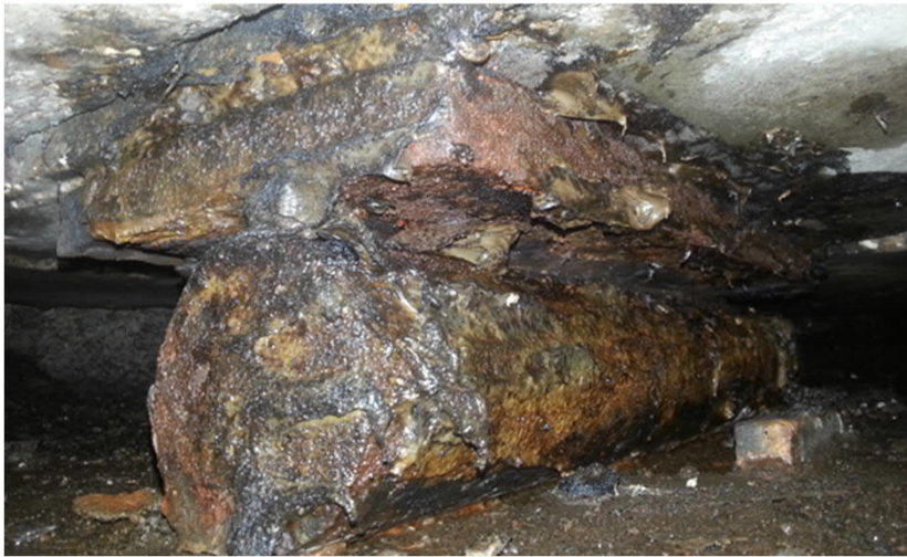
Rulleleje, som er låst på grund af korrosion – og ikke virker efter hensigten
