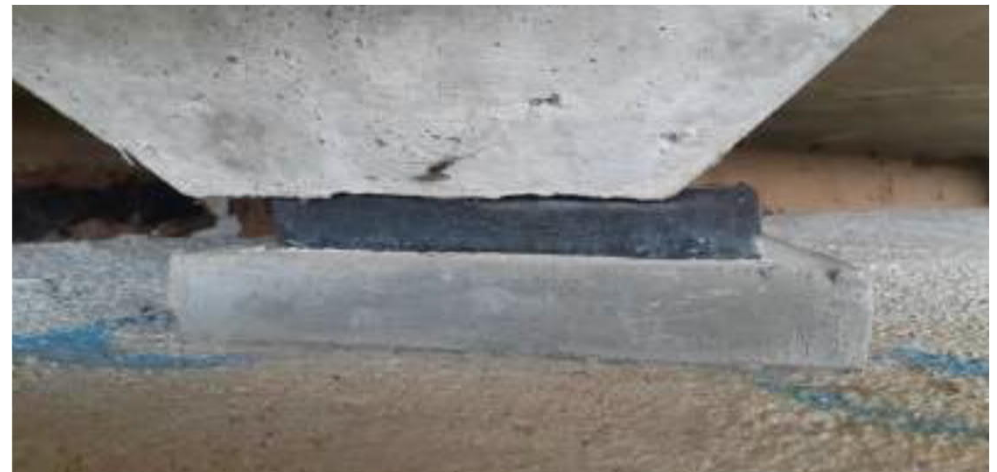
Forkert lejetype og/eller forkert placering af leje i forbindelse med installation (bevægelser og/eller udførelsessekvensens undervurderet)
