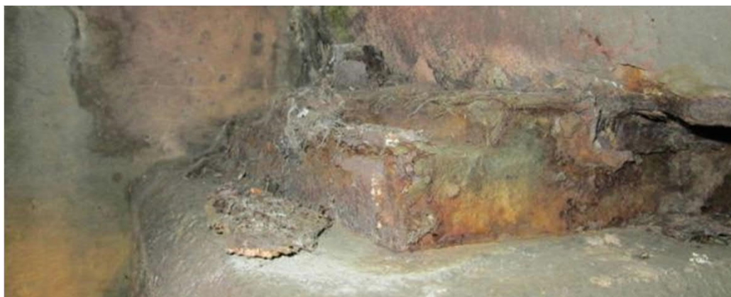
Styreleje er låst på grund af korrosion
